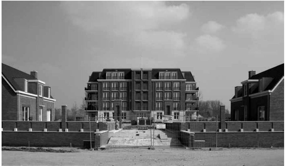
Afbeelding 2: Landgoed De Hoven bij Dordrecht (in aanbouw): de buitenruimte is alleen toegankelijk voor de bewoners. (foto: Kersten Nabielek)
